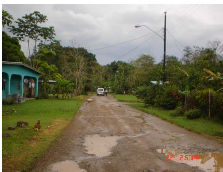
En esta foto se observa parte de las instalaciones de suministro eléctrico en la comunidad de Cacao.
