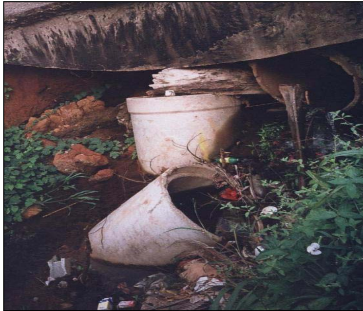
Estado de las alcantarillas en la comunidad de Aguas Claras
