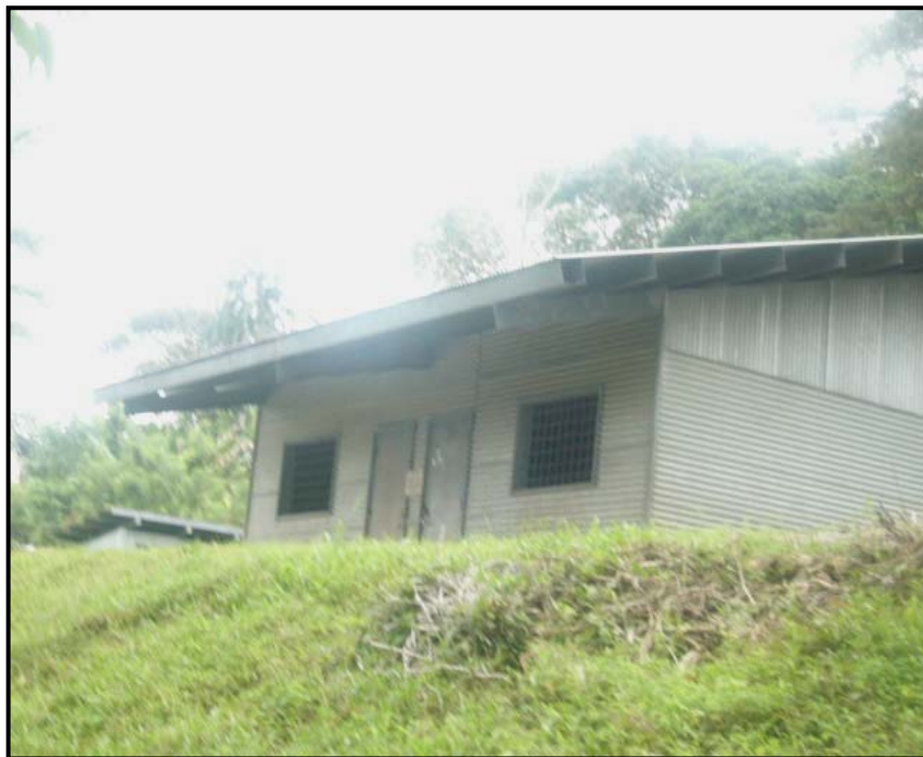
Infraestructura abandonada del puesto de salud en Arenas Blancas
