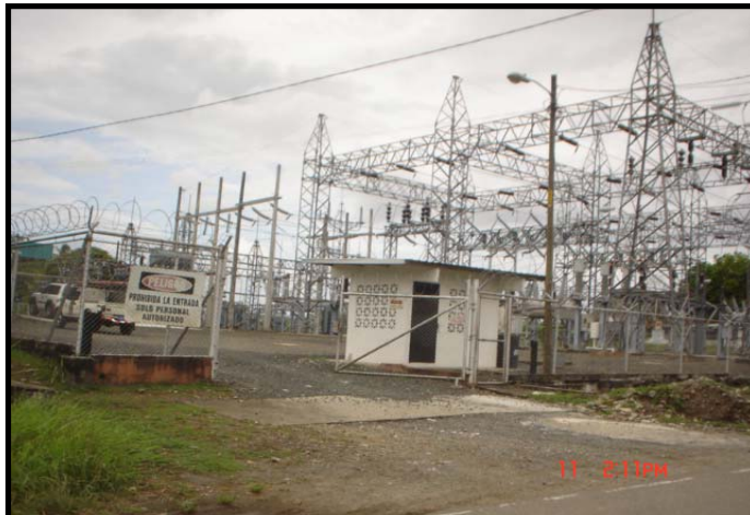
Subestación de energía eléctrica en la comunidad de Buenos Aires
