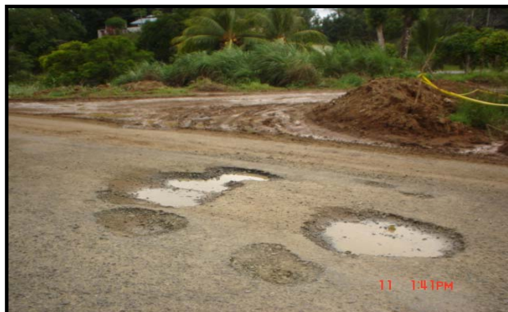
Vía en mal estado que comunica Chilibrillo con la vía Boyd-Roosevelt
