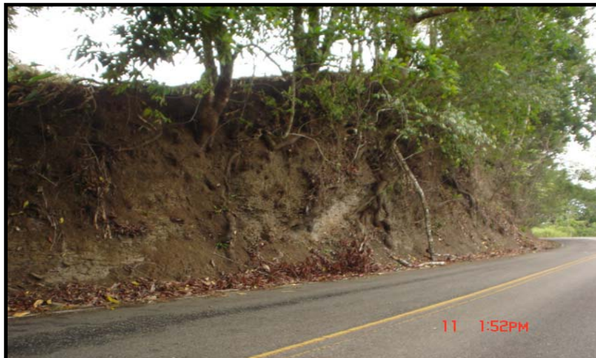
Procesos erosivos a orilla de la vía de Chilibrillo que conduce a la Y
