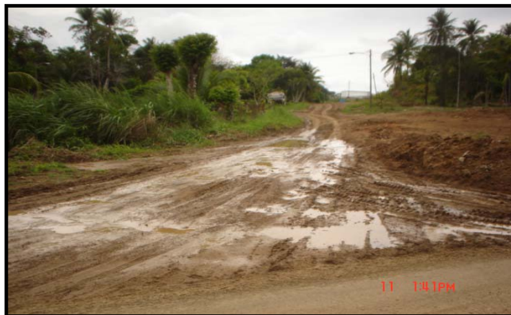
Mal estado de algunas secciones de la vía principal de la comunidad de Chilibrillo
