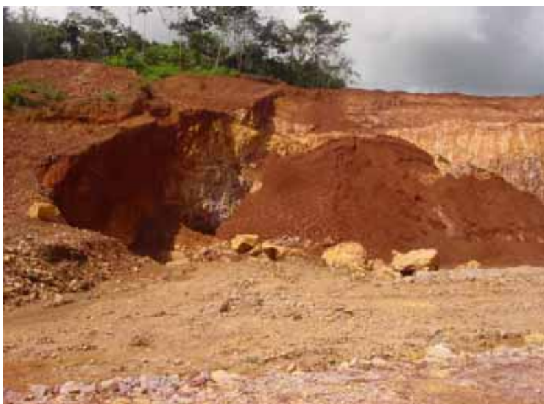
Fotografía No 15 Establecimiento de un área de extracción de material pétreo utilizado en la rehabilitación de caminos, donde no se observó el rótulo de permiso de extracción otorgado por el MICI, en la comunidad de las Gaitas
