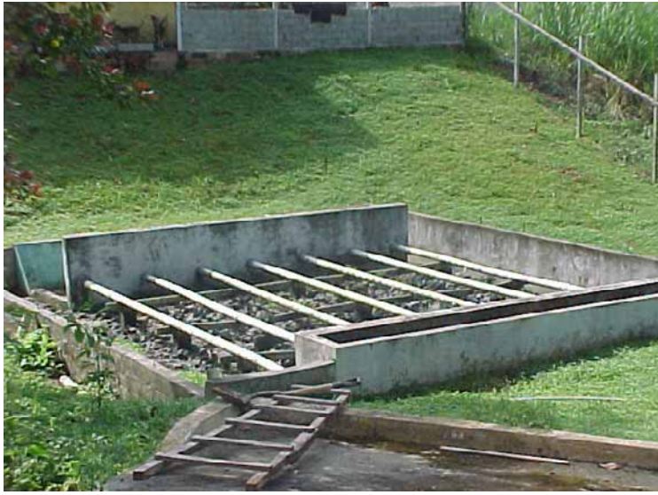
Ejemplo de un tanque séptico colapsado en una de las barriadas aledañas a la carretera Transistmica
