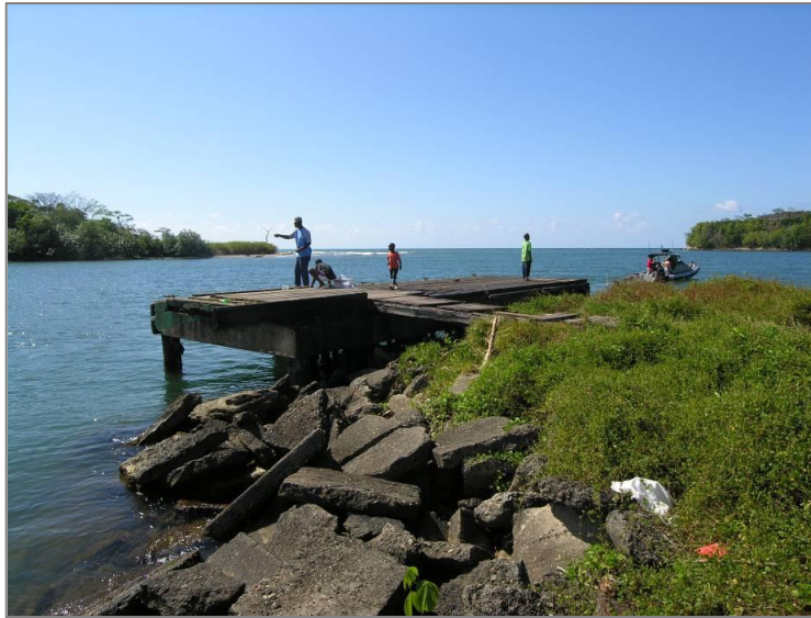
Figura 61: Muelle del periodo militar en el banco este del Río Chagres. Una cantidad considerable de piedras de concreto se ha puesto en el punto alrededor del muelle para proteger contra erosión. Bajo el muelle de concreto, se encuentran los restos de otro muelle mas viejo, hecho de acero.
