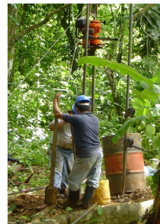
Nuevas tecnologías de pozos puntera y clorinadores..
