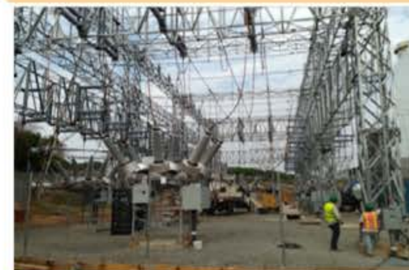
Vista de la nueva subestación eléctrica, última etapa del proyecto sólo faltando la conexión a la red eléctrica de Panamá [Marzo 2013]
