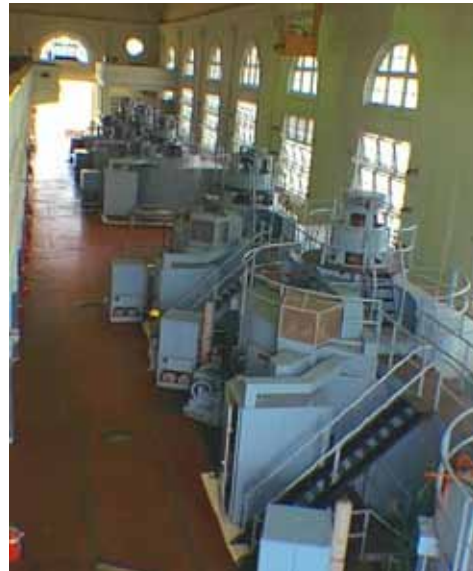
Unidades generadoras Gatún
