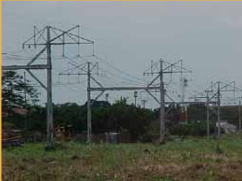
Torres tipo Track Span
