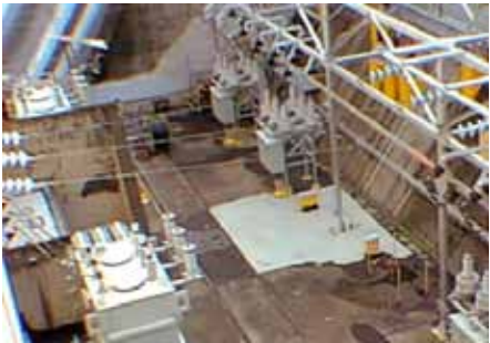
Subestación de Madden
